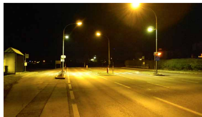
Strassenbeleuchtung Fussgängerquerung Farchat.
