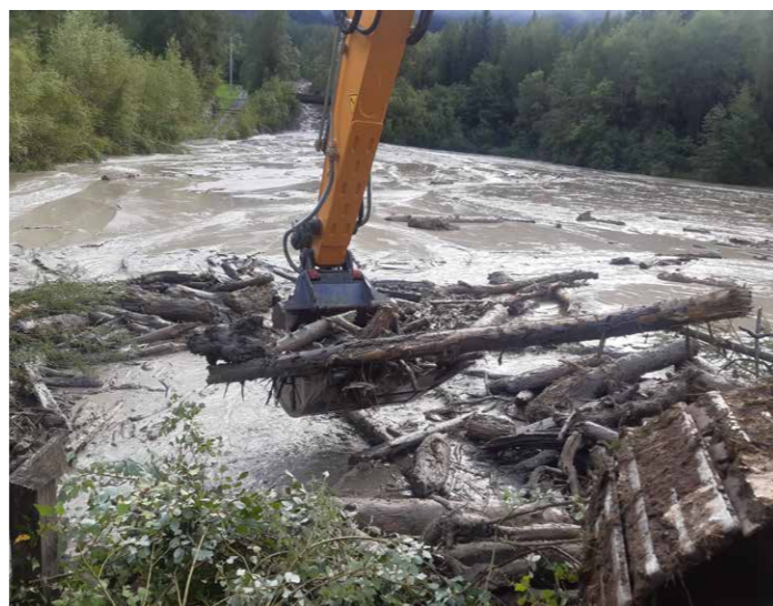
Im August kam es zu einem Murenabgang in der Farstrinne.
