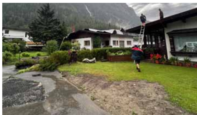
In Tumpen deckte der Sturm zwei Hausdächer ab.
