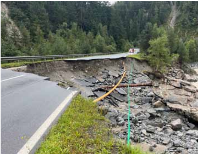
Die fortgespülte Bundesstraße.
