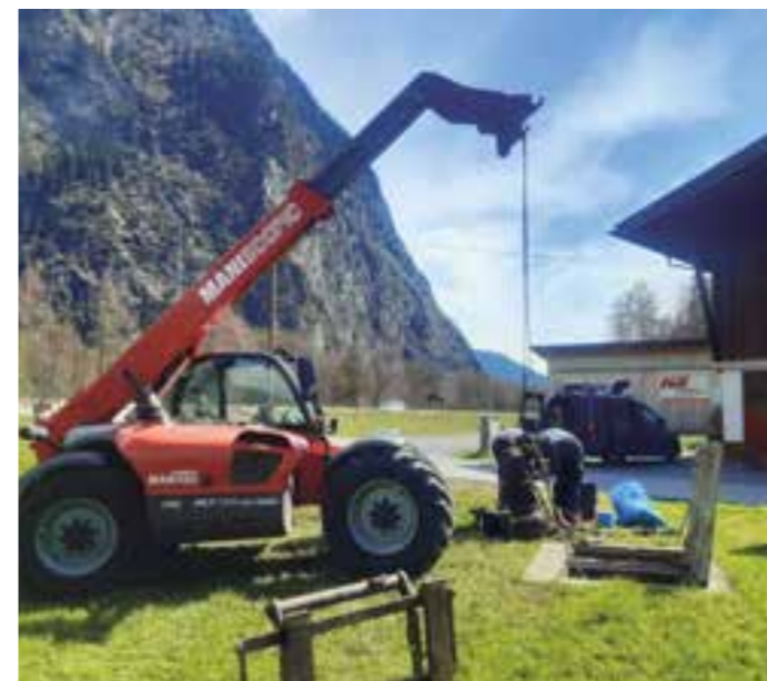
Im Frühjahr wurden Wartungen bei den Pumpstationen durchgeführt.
