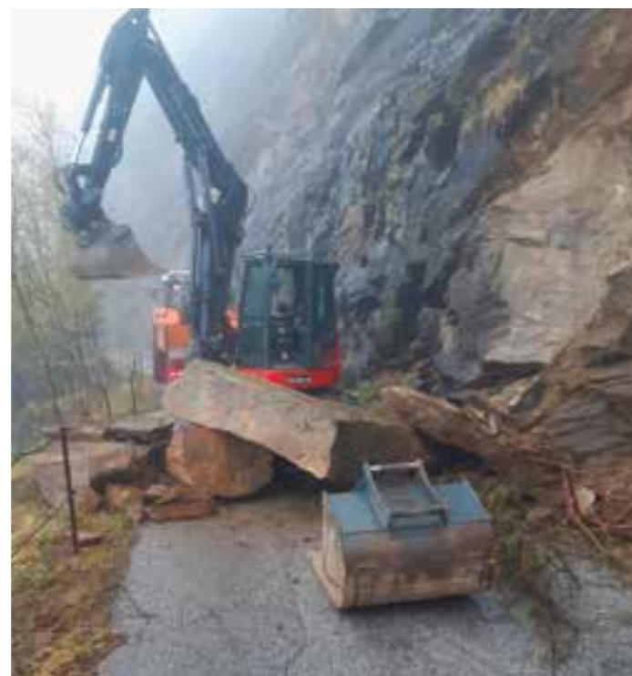
Im Frühjahr wurde die Straße zum Weiler Farst durch einen Felssturz versperrt und musste geräumt werden.
