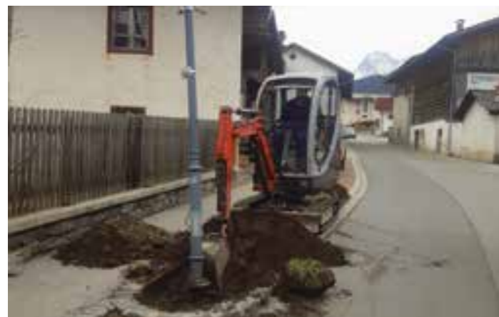
Es fallen immer wieder diverse Reparaturen von Straßenbeleuchtungen an, die von den Gemeindearbeitern durchgeführt werden.
