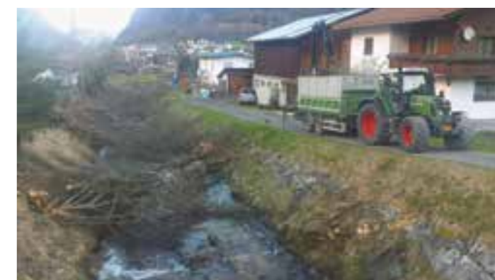
Die Wildbach- und Lawinerverbauung führte in Zusammenarbeit mit der Gemeinde Ausholungen entlang des Dorfbaches durch.
