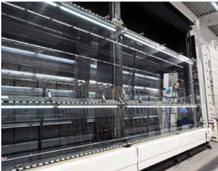
Auf der Suche nach einem Beschichtungsfehler auf der insgesamt 145m langen Isolierglaslinie.
