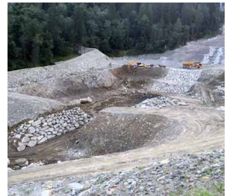
Die Bauarbeiten in Tumpen Acherbach sind abgeschlossen. Die Kosten für die Schadensbehebung betragen ca. Euro 900.000,00.
