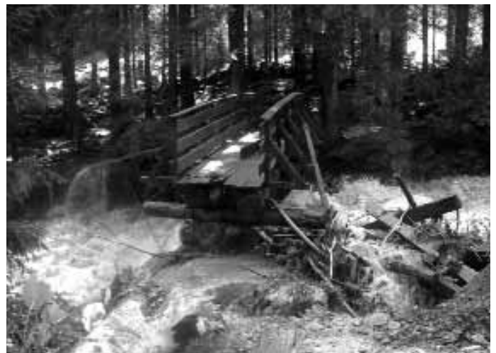
Große Schäden im Bereich Stuiben
