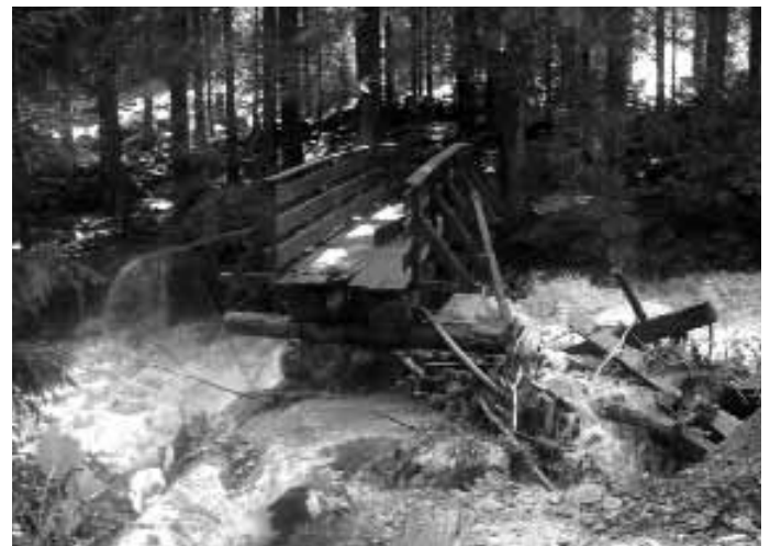
Große Schäden im Bereich Stuiben
